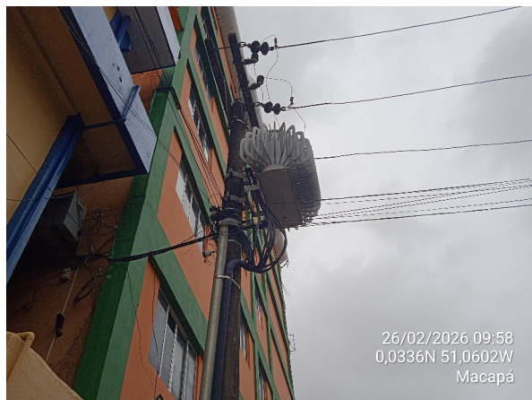
Foto 04 – Detalhe transformador elétrico.
